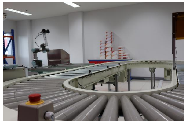
รูปที่ 1.3.7.4 สายพานลำเลียง
